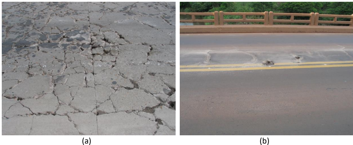
Figura 9 - Detalhe de pavimento de concreto fissurado (a) e reflexão de trincas do pavimento rígido no pavimento flexível (b).
