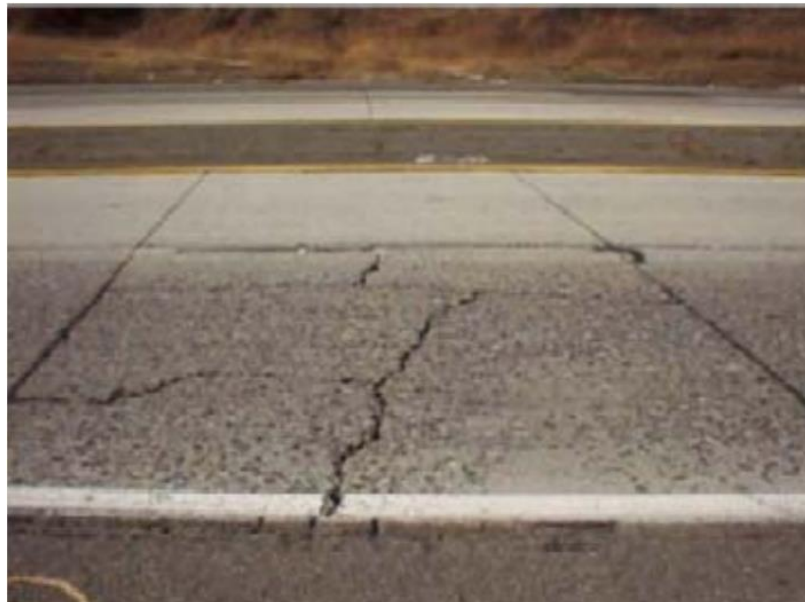
Figura 2 - Superfície de pavimento de concreto com abrasão severa e fissuras
