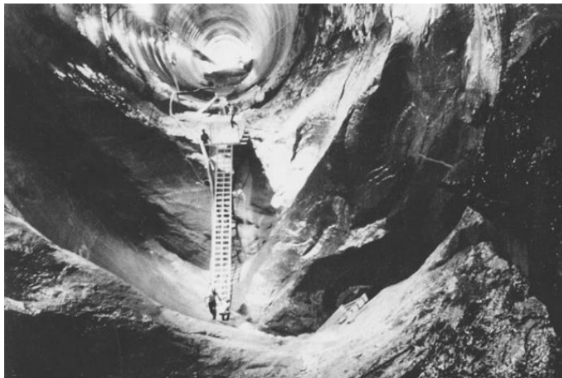
Figura 4 - Dano por cavitação no túnel da Barragem de Glen Canyon
