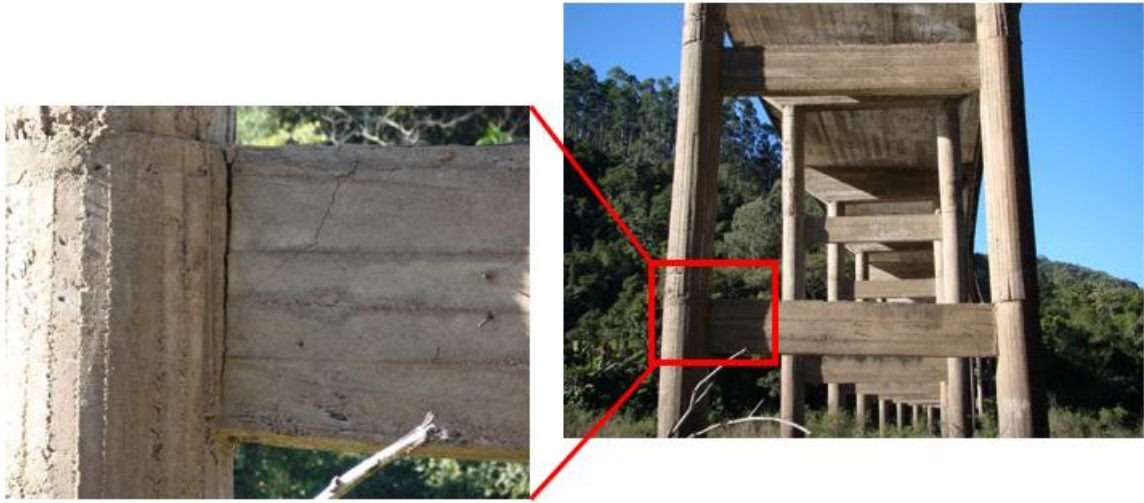
Figura 7 – O recalque do apoio da direita provocou o surgimento de fissuras na viga de travamento
