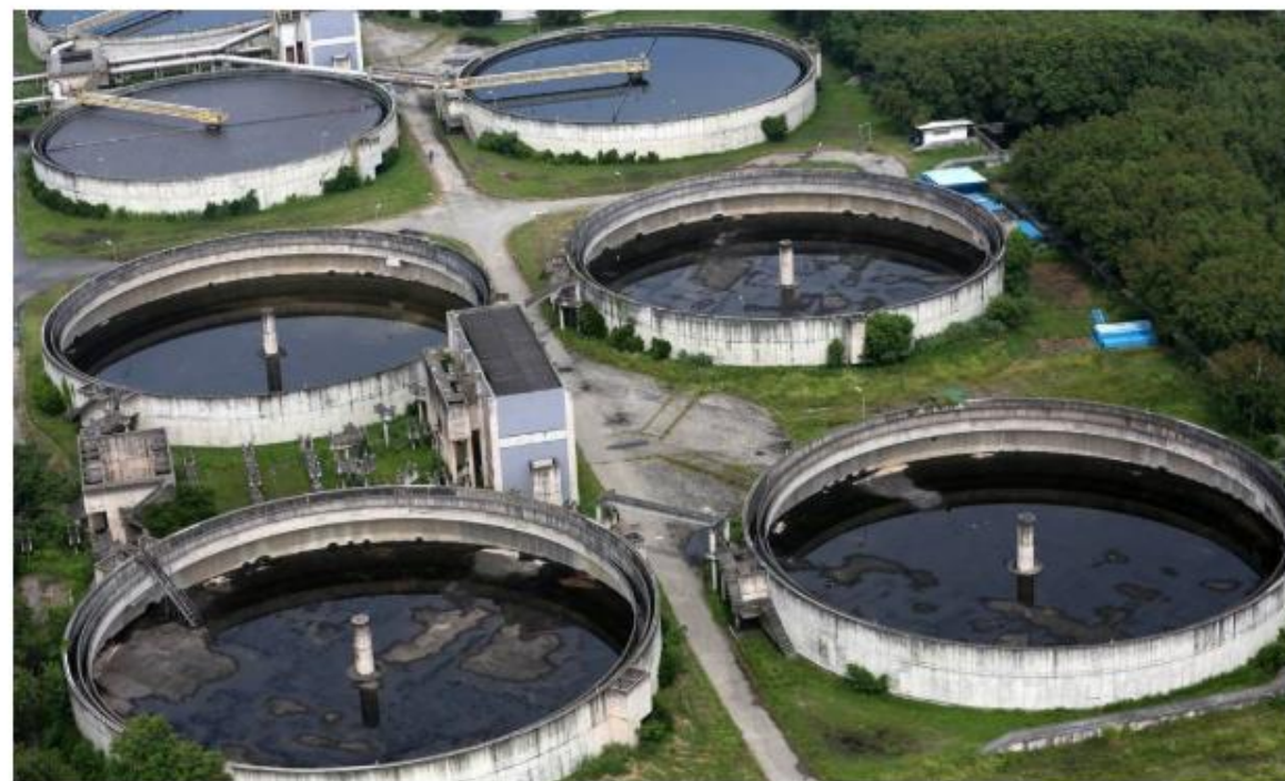
Estação de tratamento de esgoto da Cedae, no Rio Foto: Custódio Coimbra / Agência O Globo
