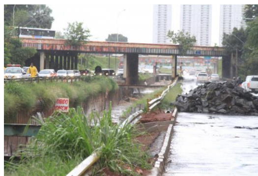
Figura 5 - Marginal Botafogo com o com asfalto danificado após a precipitação. Fonte Reprodução/TV Anhanguera
