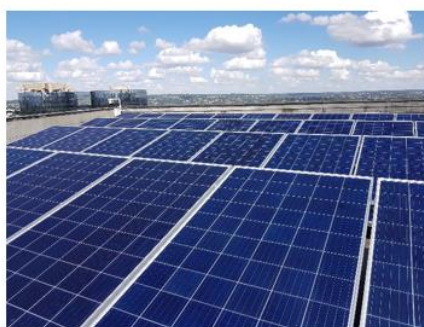
Exemplo 7- EIXO TEMÁTICO ENERGIA – Instalação de usina fotovoltaica no TCU.
