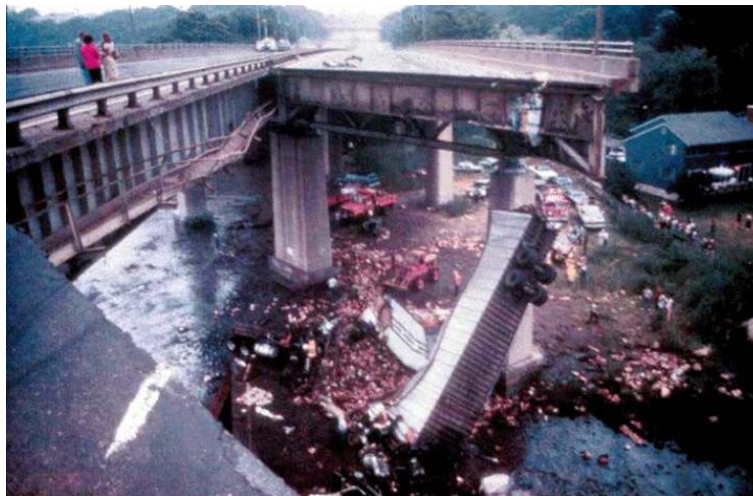
Figura 3 - Mianus River Bridge após colapso de um dos vãos por fadiga
