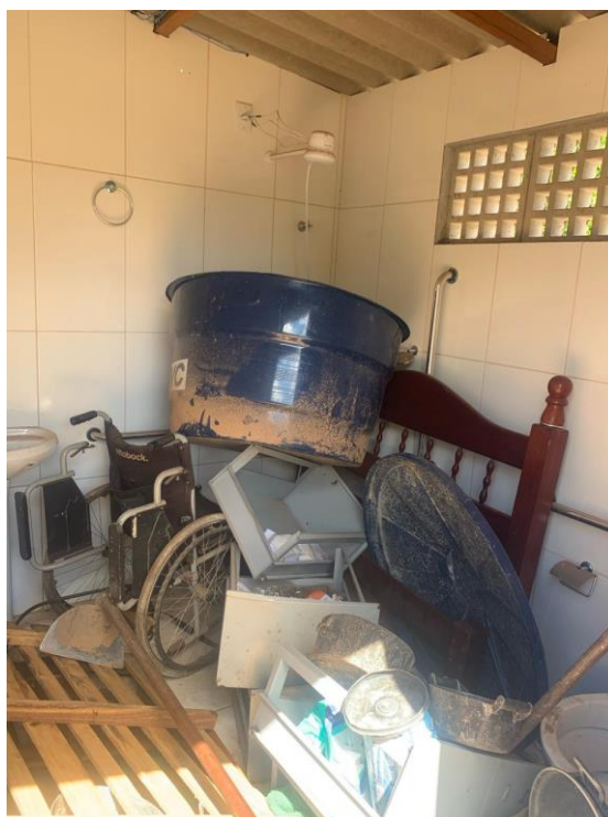
Figura 29 - Banheiro adaptado para PCD cadeirante usado como depósito.
