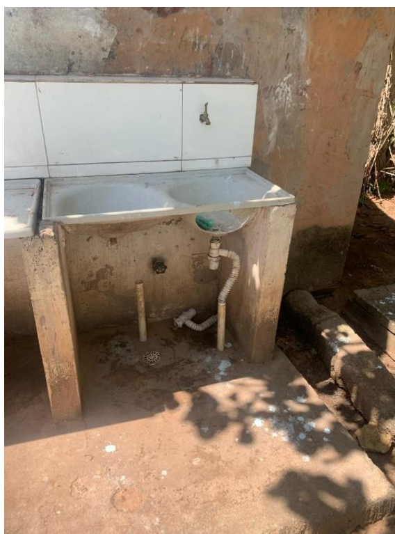
Figura 30 - Tanque e pia, em área externa, sem condições de uso.
