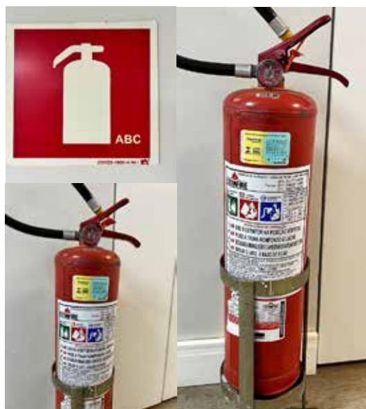
Figura 2 - Tipo de extintor
