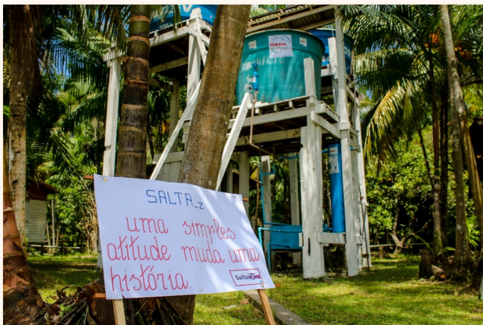
Figura 9 - Solução alternativa de Tratamento de Água com Zeólita.
