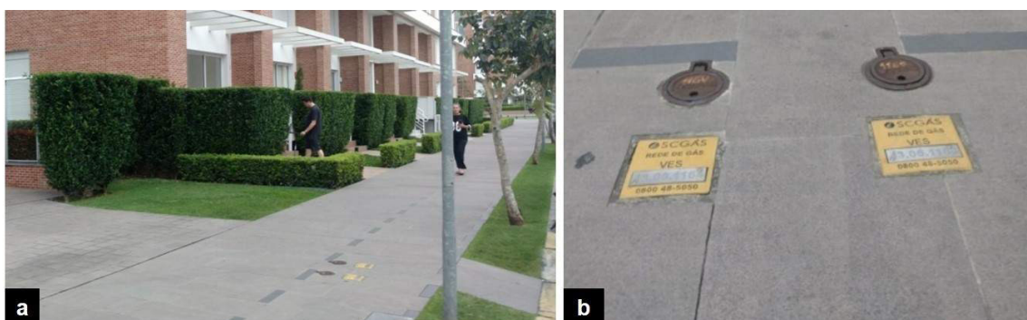
Fig. 39: a) Mostra infraestruturas de gás (em amarelo), com caixas bem organizadas na faixa de serviço/ciclofaixa, fora da faixa livre. Podemos notar a presença de caixa de energia perto do poste de iluminação pública, fora da área de faixa livre. Bairro Pedra Branca, Florianópolis (SC). b) Mostra detalhe de infraestruturas de gás. Fonte das imagens: Acervo pessoal de Rafael Campos.
