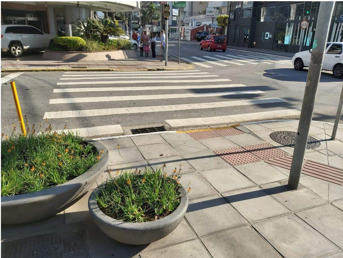
Fig. 38: Placas de redes subterrâneas, floreiras e postes de sinalização urbana, são exemplos de obstrução na pavimentação das calçadas que condicionam a instalação de pisos táteis e rampas para travessia. Uma possível solução é a instalação destas caixas apenas na faixa de serviço. Fonte: Acervo pessoal de Marta Dischinger.
