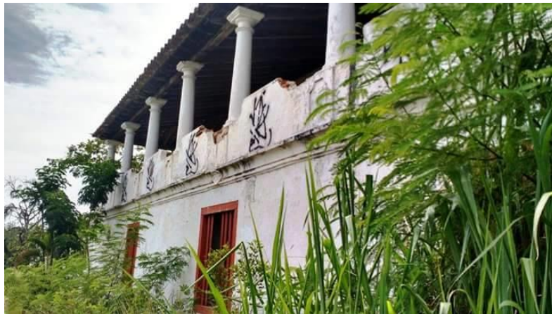
FOTO 12 – ABANDONO DA FAZENDA - IMAGEM GOOGLE
