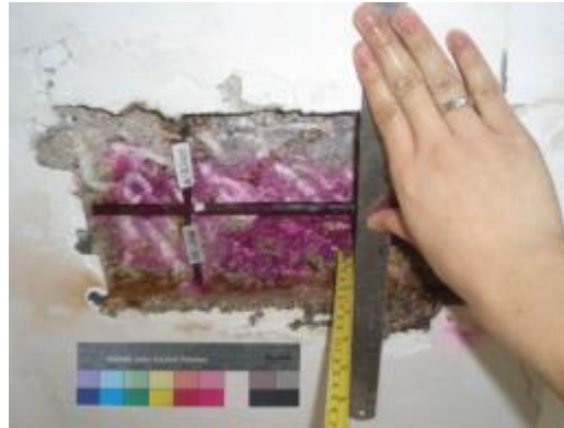
Figura 25 - Uso de fenolftaleína para avaliação do avanço da frente de carbonatação.
