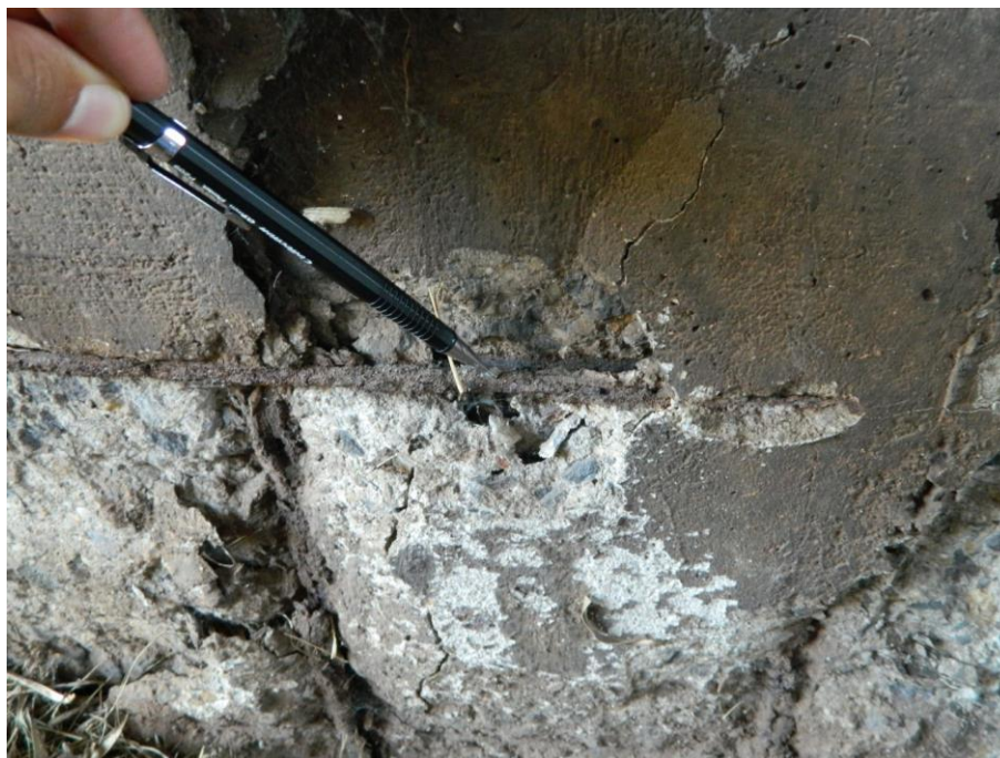
Figura 3 - Corrosão de armadura com deslocamento do concreto na base de um pilar.
