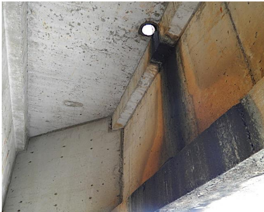
Figura 6 - Dreno mal posicionado provocando manchas na estrutura.
