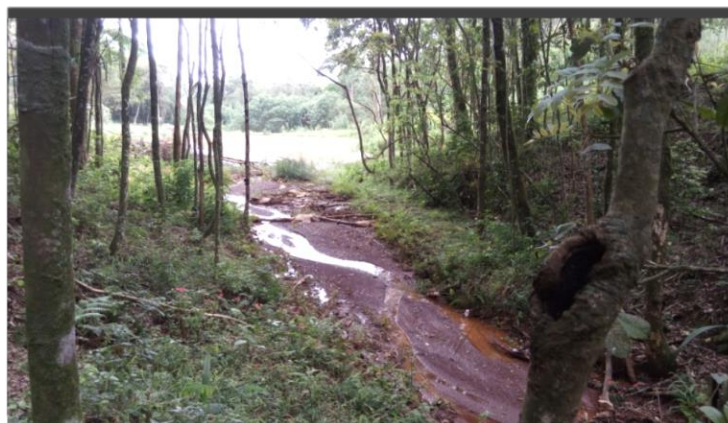
Figura 05 Loteamento urbano em execução apresentando danos ambientais para Área de Preservação Permanente – outubro 2018
