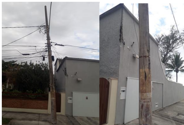
Fot. 3: Excesso de carga cabos de telecomunicações com dano evidente no poste de distribuição de energia elétrica. Fonte: próprio.
