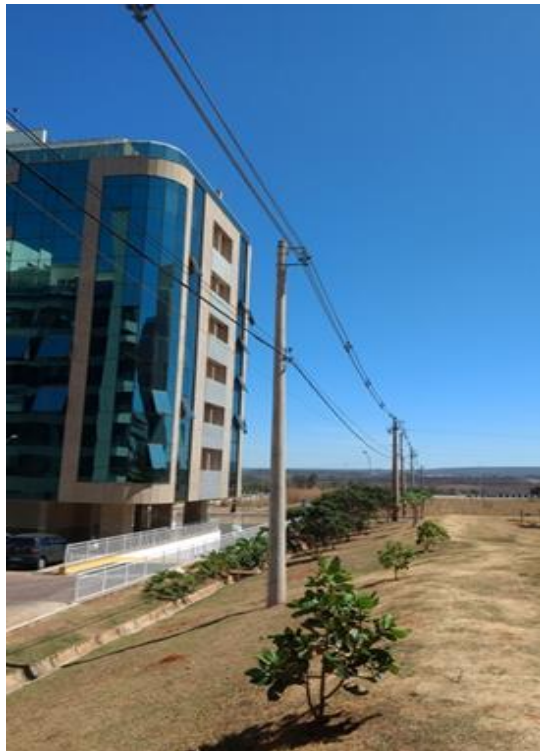
Fot. 1: Falta de identificação cabos empresas de telecomunicações. Fonte: próprio.
