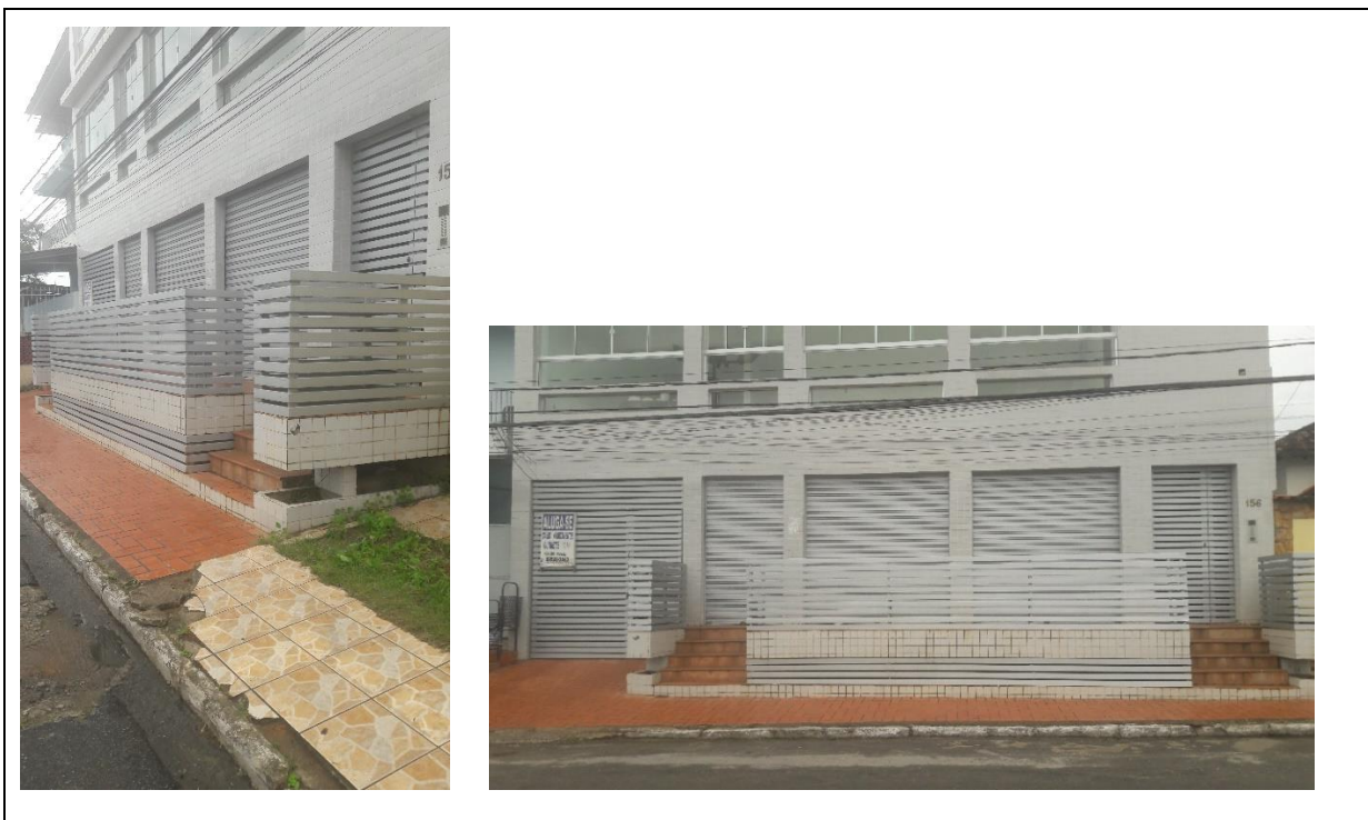
Fotos 11 e 12: Loja 156 - Calçada sem acessibilidade – Rua José Túnula/Seropédica
