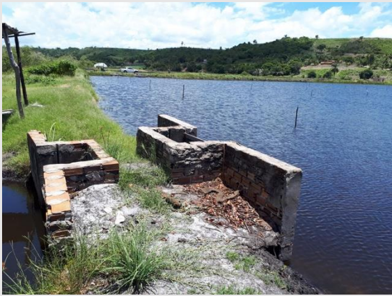
Comporta de abastecimento/drenagem
